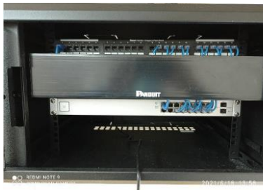
IDF- Edificio_C - 604 (2do Piso)
